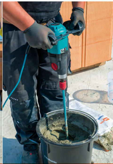
Anmischen des Dünnbettmörtels
