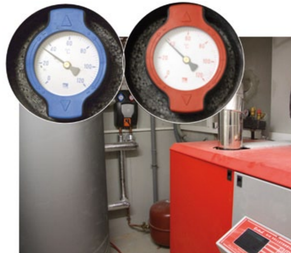
Energiesparend durch Niedertemperatur und geringe Wärmeverluste (Spreizung 2 - 5°C)
