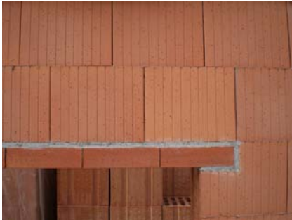
Bild 3: Flachsturz aus Ziegelmauerwerk mit Übermauerung ohne Stoßfugenvermörtelung nach [4]
